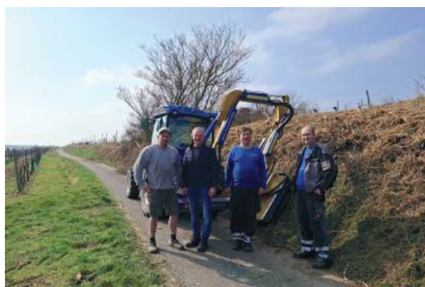
GGR Andreas Schuster gemeinsam mit den Arbeitern beim Rückschnitt entlang eines Güterweges –Pflege sorgt für Sicher- heit und freie Befahrbarkeit.
